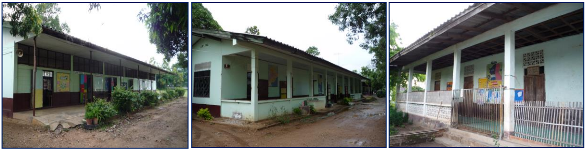
รูปภาพที่ ๑ แสดงสภาพอาคารเรียนและสภาพสิ่งแวดล้อมก่อนการพัฒนา
